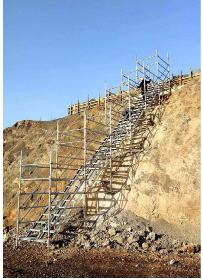
大連灣海底隧道斜坡走道梯架
